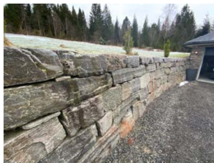
Det mangler sikringsgjerde på topp av støttemur.
