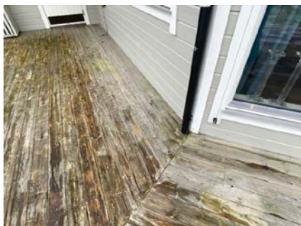
Det mangler overgangsbeslag og det er liten avstand til kledning.
