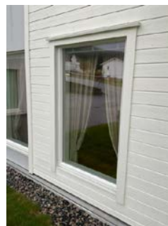
Vindu uten overbygg, mangler beslag over
