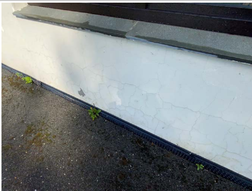
12. Kalkutfelling på betongvegg i u.etg
