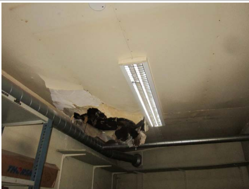
108. Lager tilkn. vaktmesterfløy. Fuktskade i himling.
