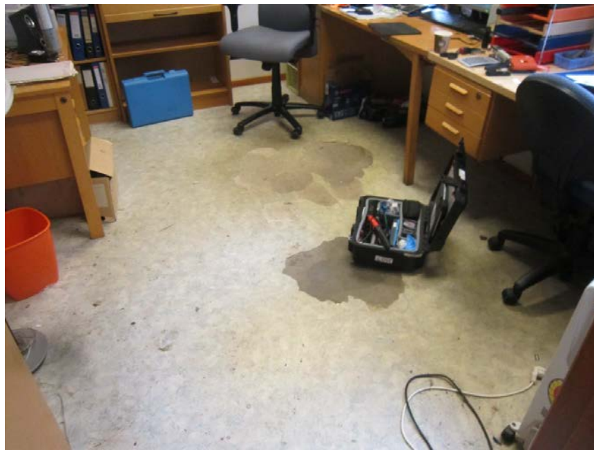
105. Vaktmesterkontor: Skader på gulvbelegg.
