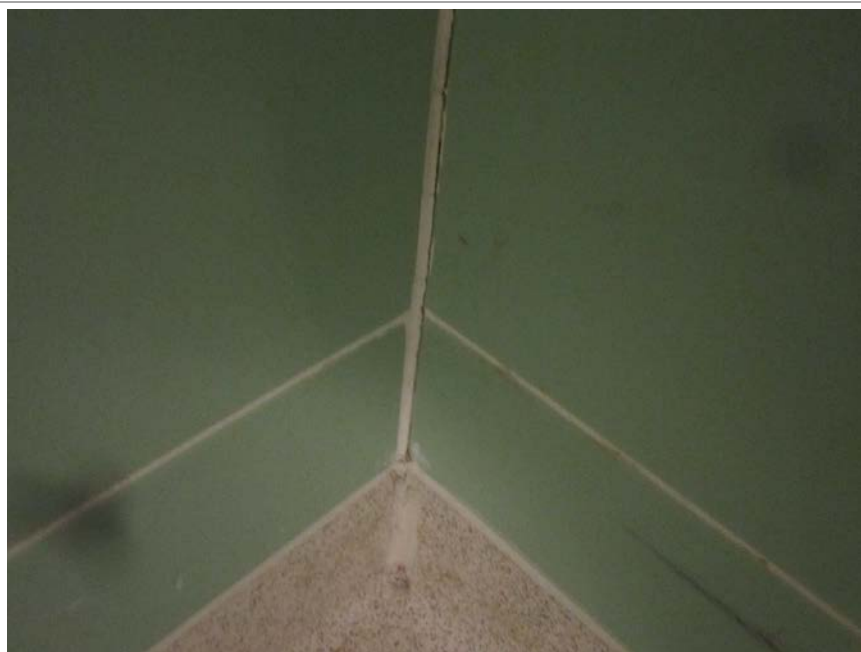
58. Baderom, kontor 002. Sprekk i fuger i dusjhjørnet. Dette er en fellesnevner for alle pasientrom i denne etasjen.
