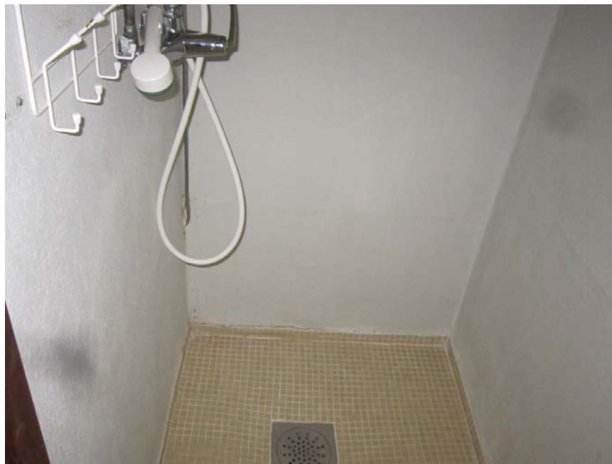
103. Damegarderobe: Dusjrom. Sprekker i overgang mellom kantflis og vegg.
