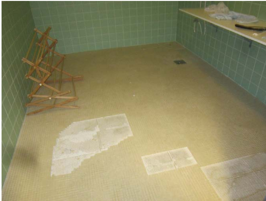
71. Rom 010, tørkerom. Mosaikkflis har løsnet fra gulvet.
