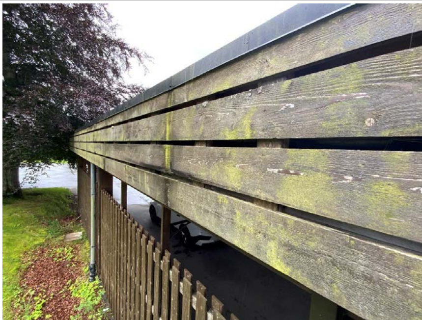
30. Gesimskasse v. carport. Bør skiftes til vedlikeholdsfrie fasadeplater.
