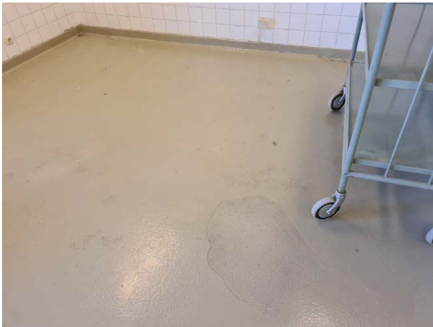
130. Storkjøkken, skader på e-poxy gulv.
