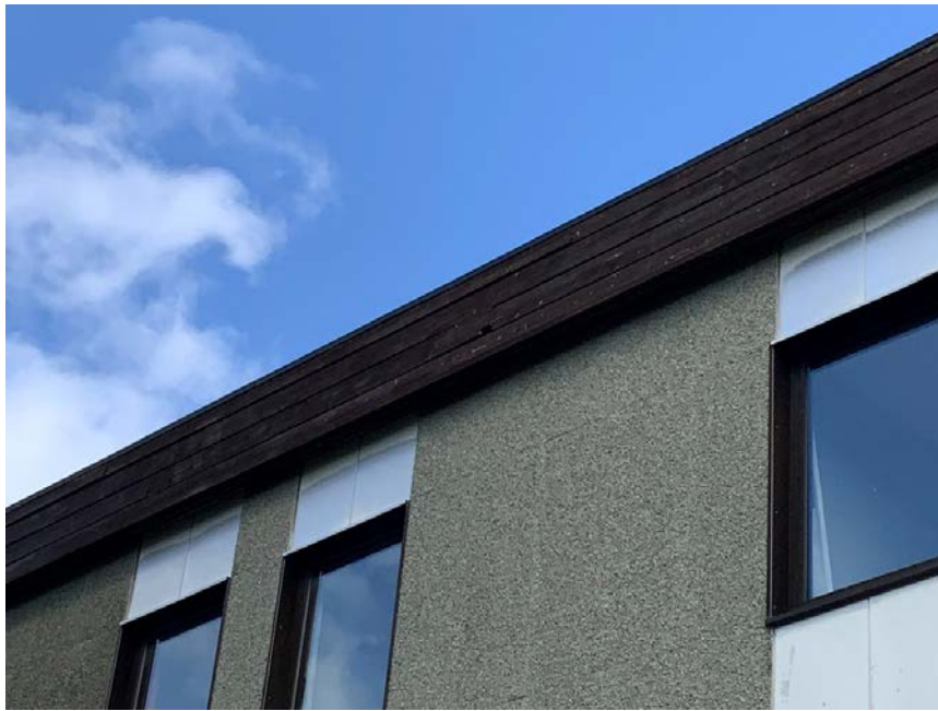
13. Gesims: Skader på kledning og løse bord.
