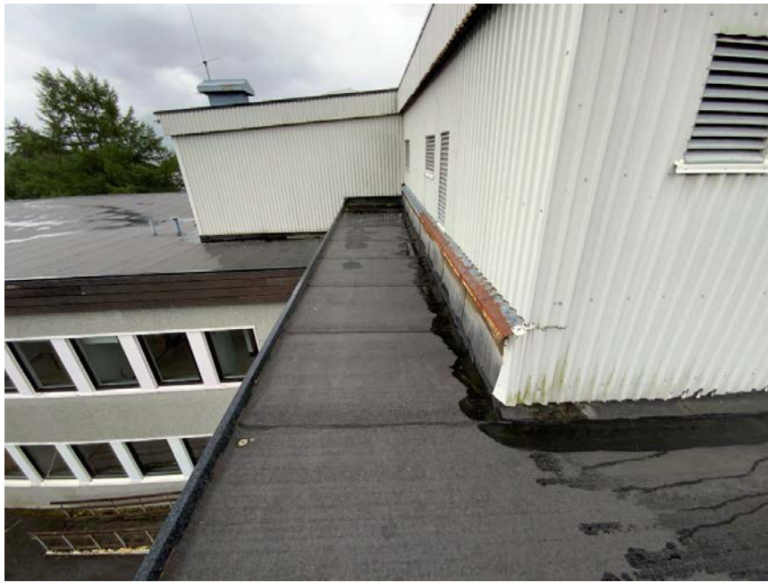
19. Rustet beslag og løsnet/vekkvridd veggplate.
