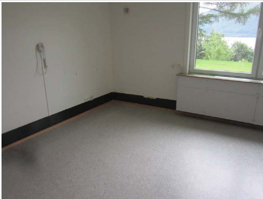
60. Saltutfelling på yttervegg, rom 004. Tilsvarende skade finnes på alle pasientrom i denne etasjen.
