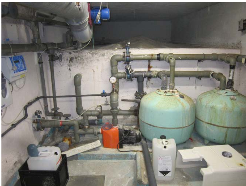
33. Teknisk anlegg til svømmebasseng.
