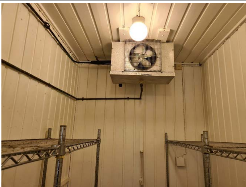
126. Storkjøkken, aggregat på kjølerom.
