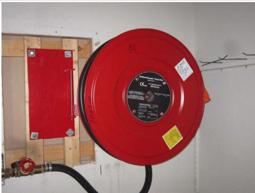
88. Slukkeutstyr i 1.etg, godkjent. Sist kontrollert februar 24.
