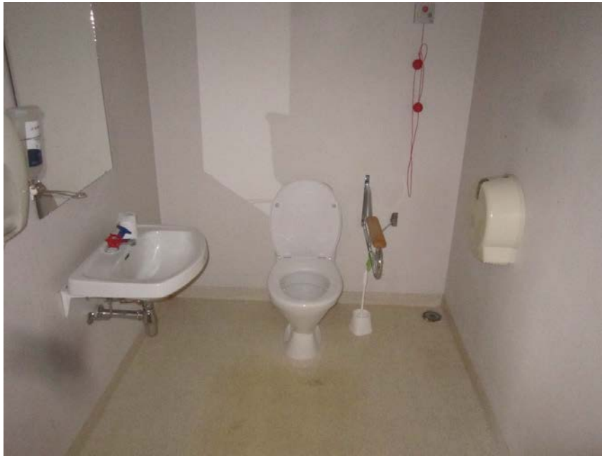
91. 1.etg, WC. Slitte overflater.
