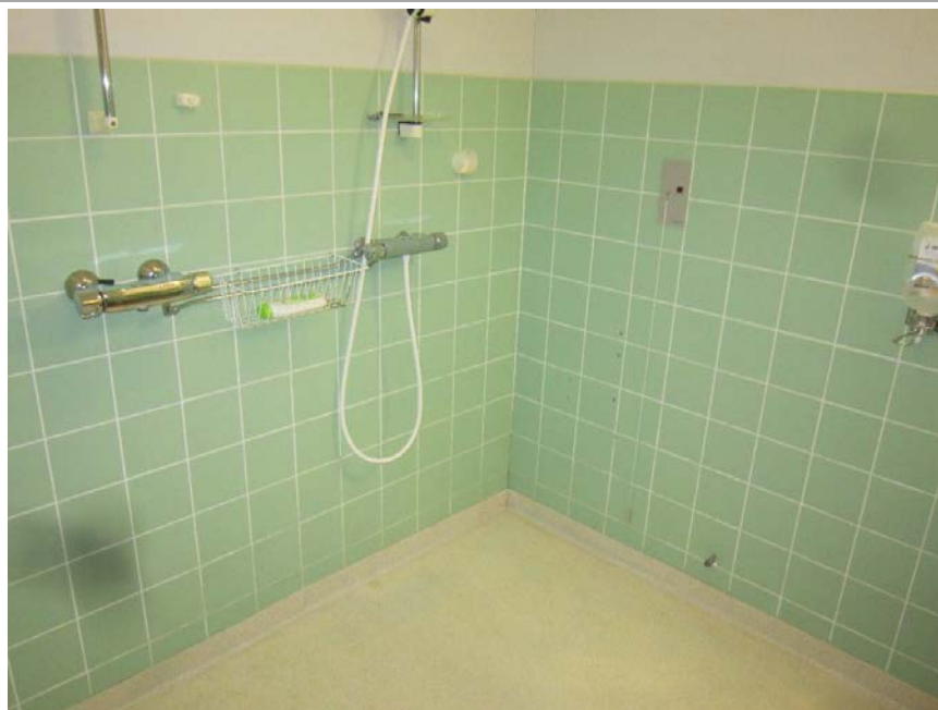
57. Baderom, kontor 002. Sprekk i fuger i dusjhjørnet. Dette er en fellesnevner for de fleste pasientrom i denne etasjen.
