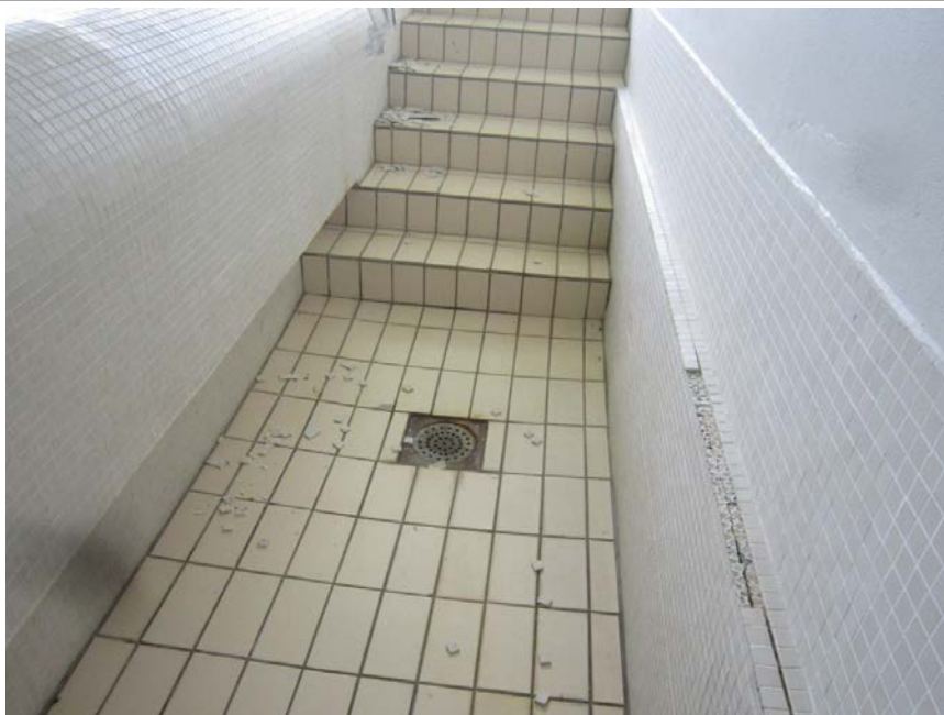
38. Svømmehall, fliser løsnet fra vegg
