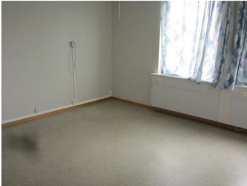
81. Pasientrom, slitt gulvbelegg og overflater.
