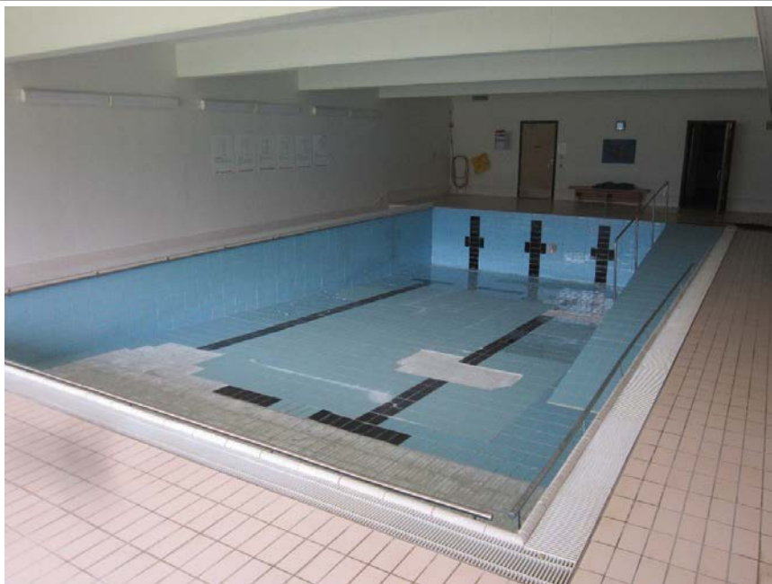
36. Svømmehall, fliser løsnet fra bassengbunn.
