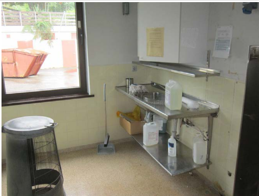
86. Rom 116, skyllerom. Slitte overflater, vannskade i vegg.
