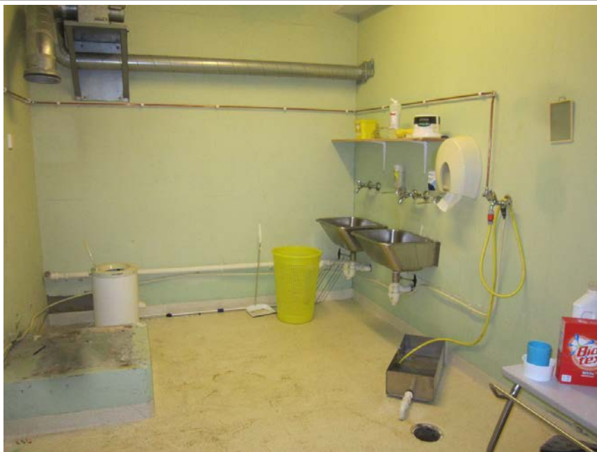
72. Vaskerom, slitte overflater og skader på vegg.
