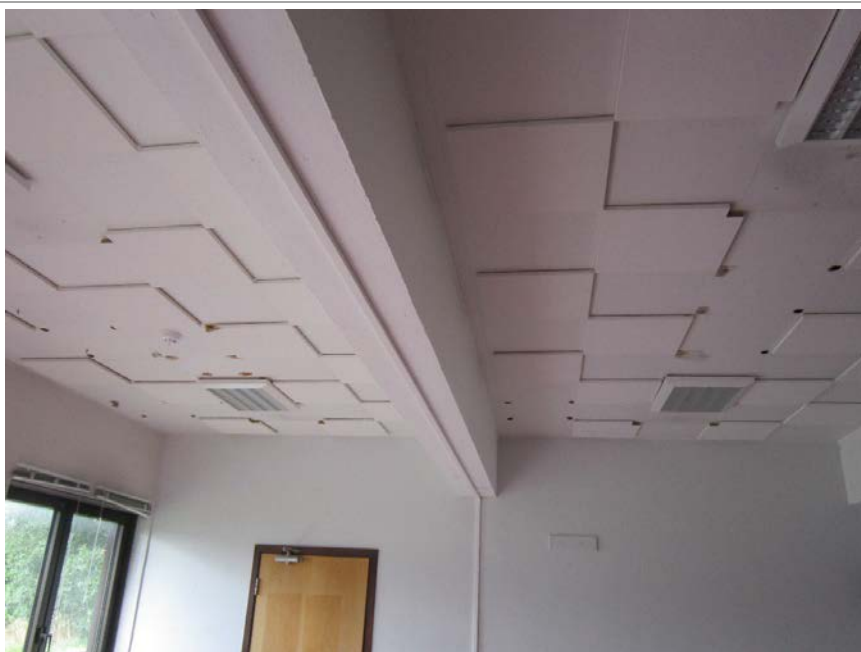
54. Himling i korridor mellom svømmehall og kontor. Flere akustikkplater har falt ned fra himling.
