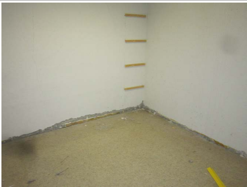
74. Lager, saltutslag på vegg, slitte overflater.
