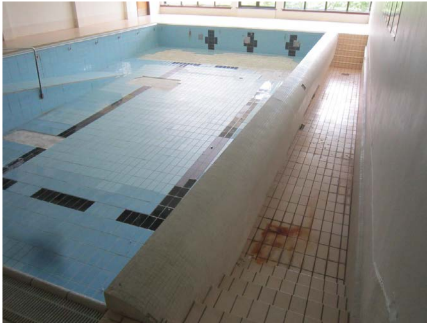
37. Svømmehall, fliser løsnet fra bassengbunn.
