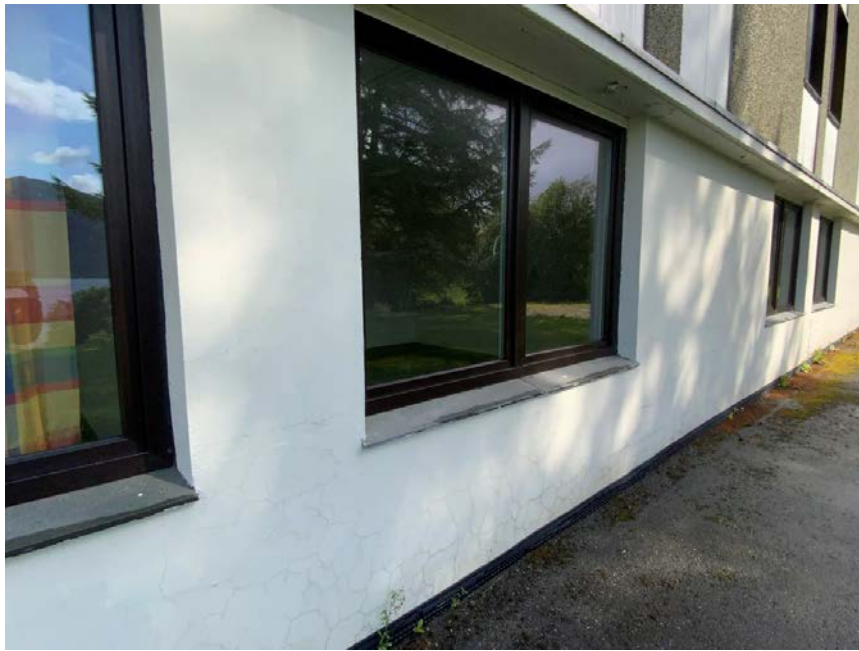
11. Kalkutfelling på betongvegger i u.etg
