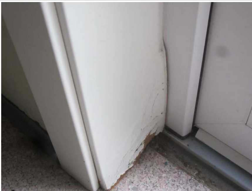
102. Fuktskade på foringer, ref. bilde 100..
