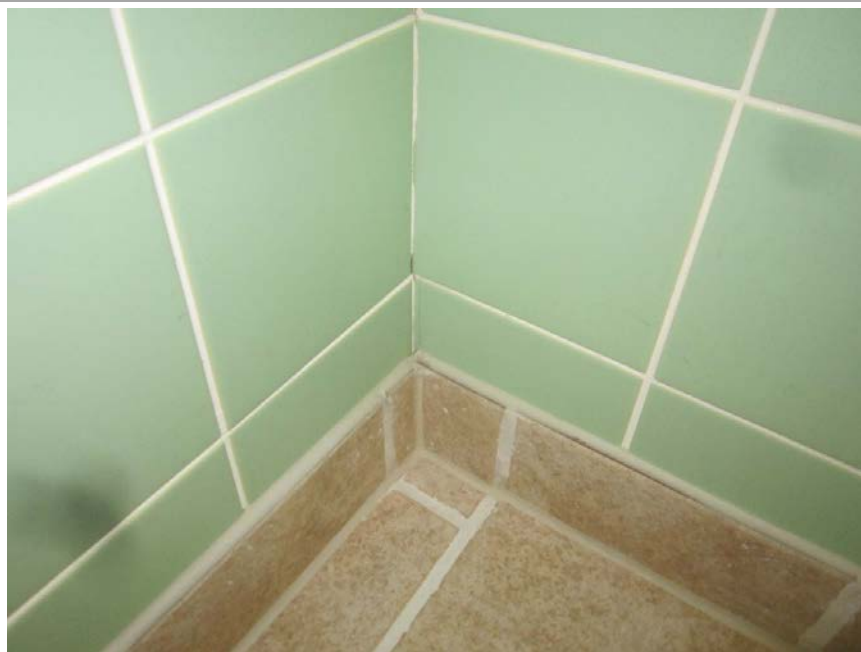
67. Rom 008, baderom. Sprekk i fuge.
