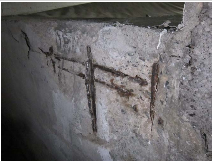
77. Under svømmebasseng. Rustsprengning fra armering.
