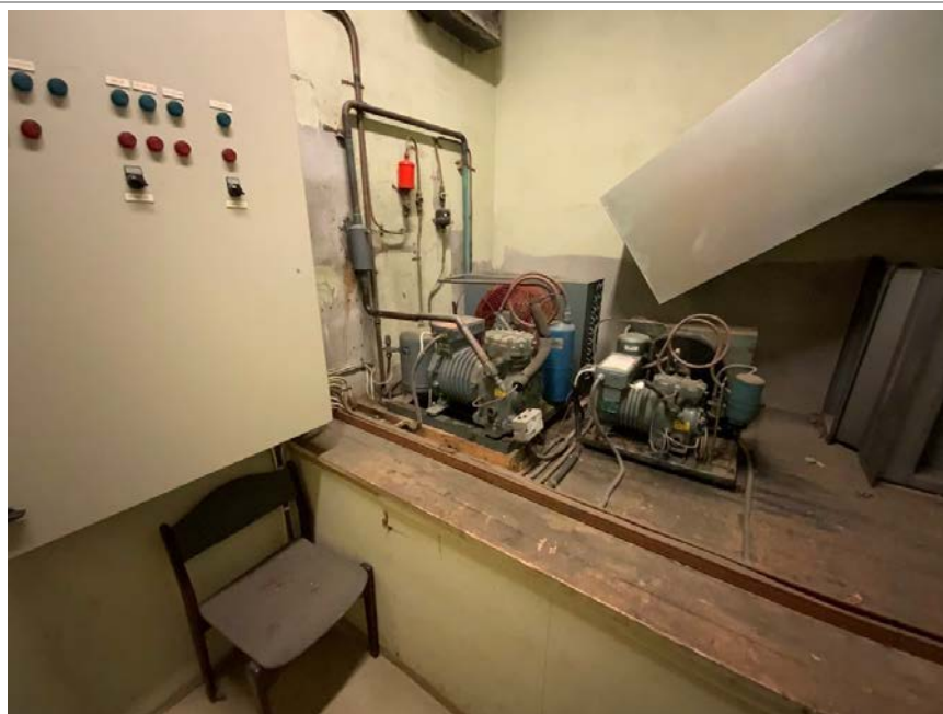
134. Teknisk rom tilkn. heisrom. Kjølekompressorer av eldre dato
