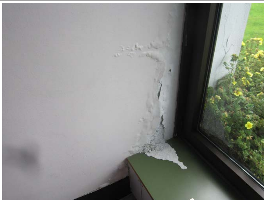
56. Fuktskade, ref. bilde 55.
