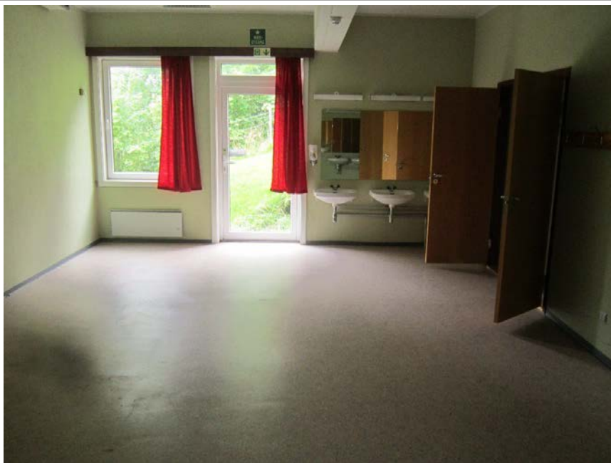
100. Damegarderobe. Fuktskade på foringer, PVC-dør fra 2023.
