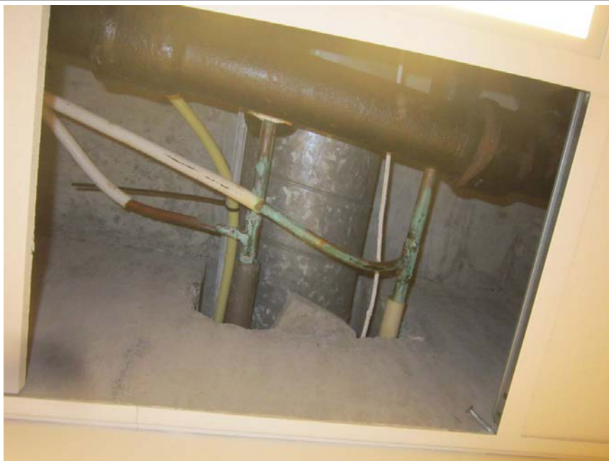
44. Irr på kobberør i garderobehimling.
