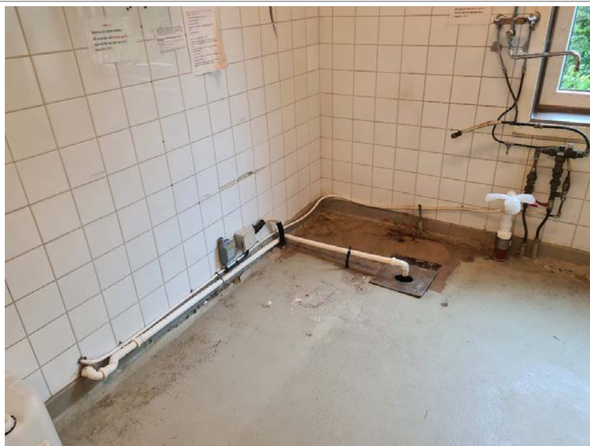
118. Storkjøkken, skader på e-poxy gulv.
