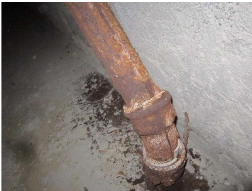
35. Avløpsrør under svømmebasseng
