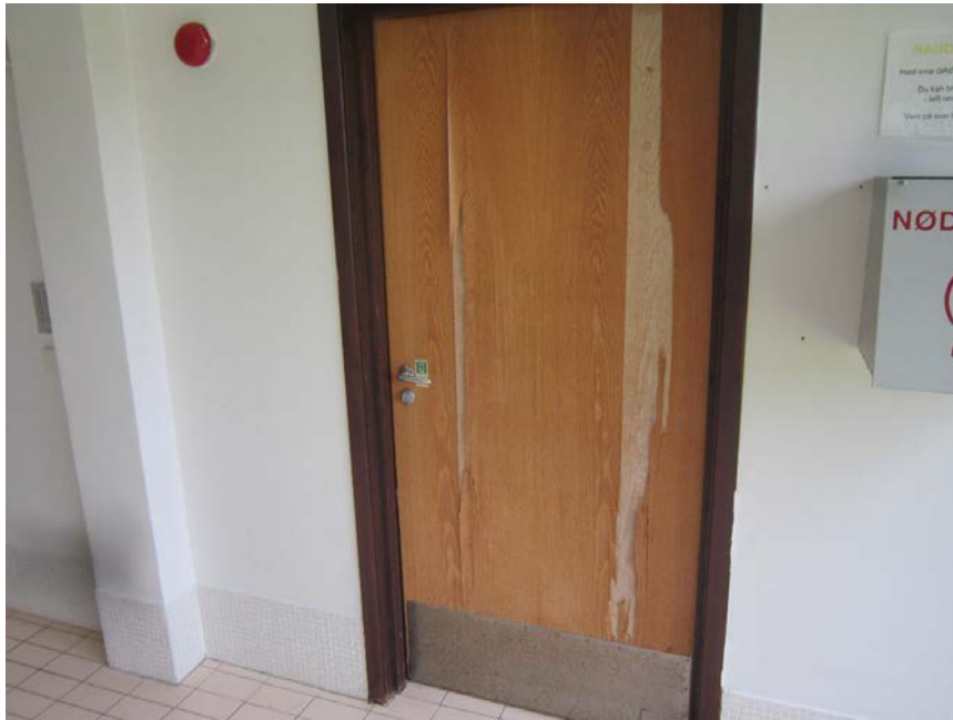
41. Svømmehall: Skader på innerdør, bør skiftes.
