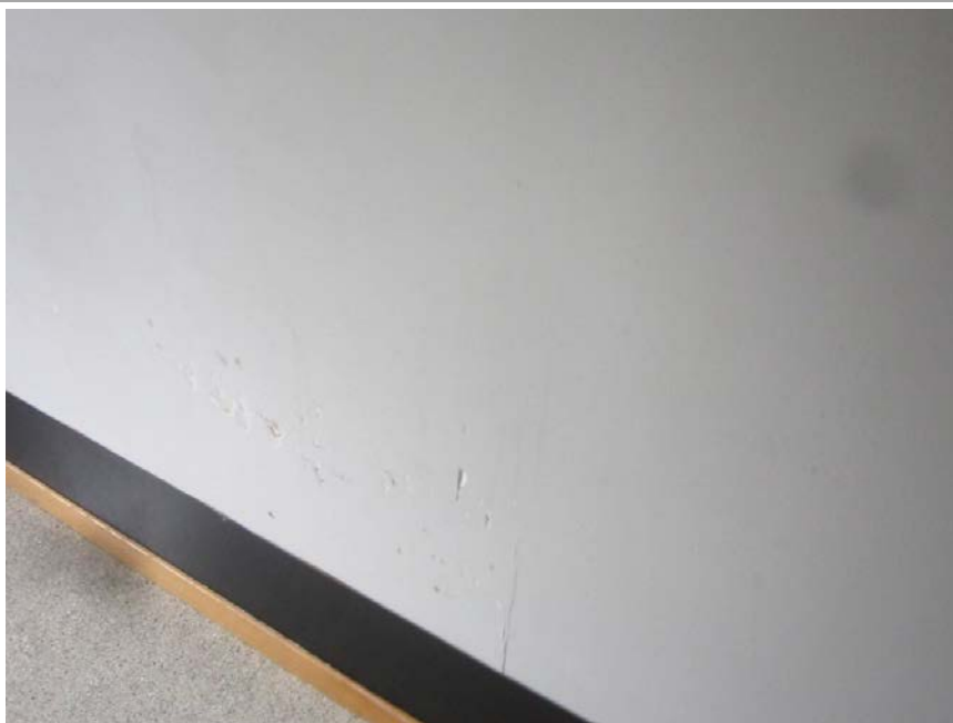
83. Pårørenderom (113-114), skade på vegg. Slitte overflater.
