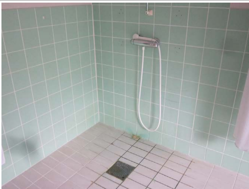
84. Rom 115, baderom. Slitte fliser på gulv og vegger.
