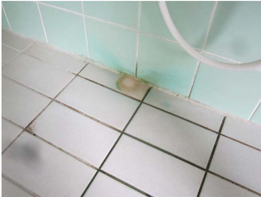
85. Rom 115, baderom. Slitte fliser på gulv og vegger.
