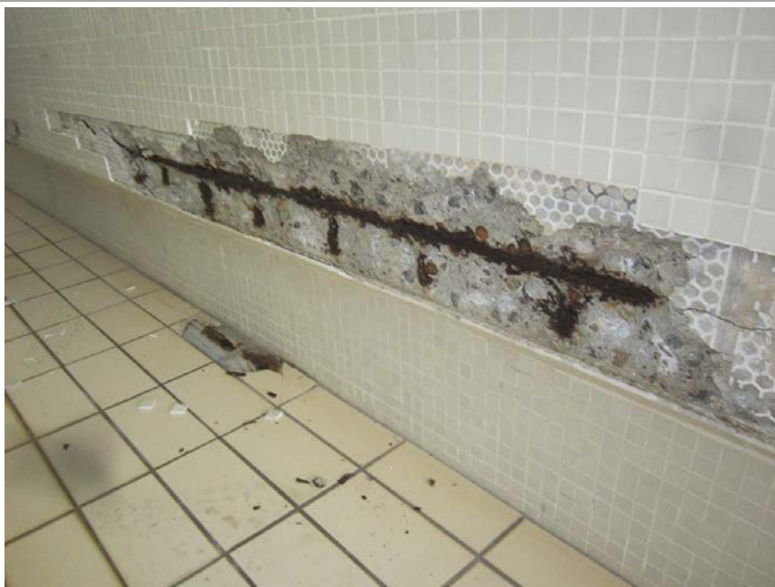
39. Svømmehall: Rustspregning fra armering i betongvegg.
