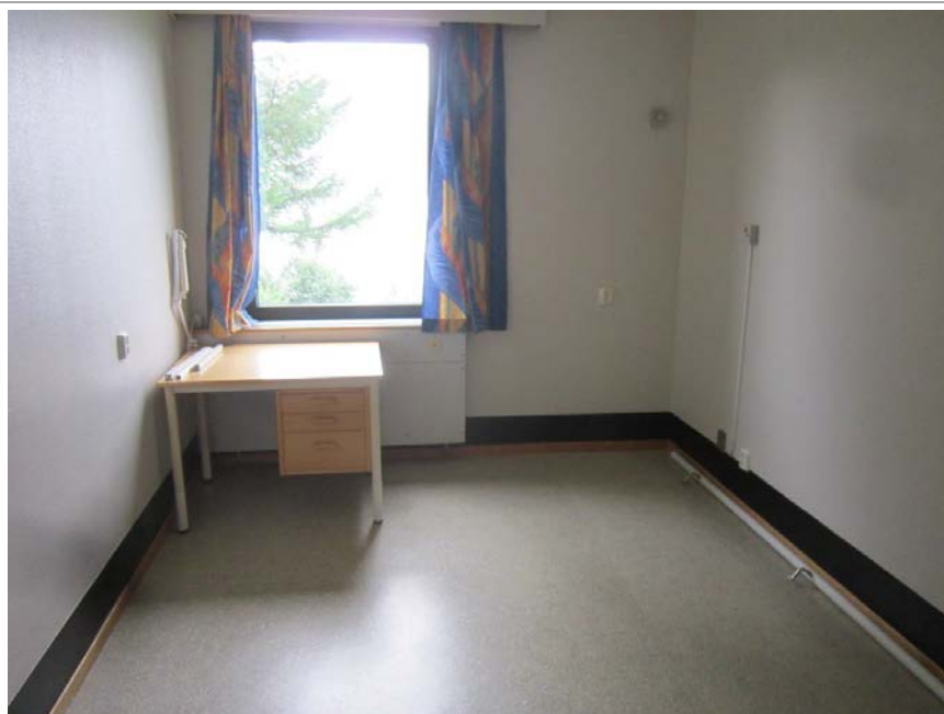
80. Kontor: Slitt gulvbelegg og overflater.
