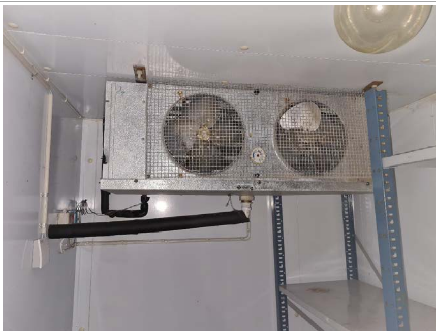
124. Storkjøkken, aggregat på fryserom.
