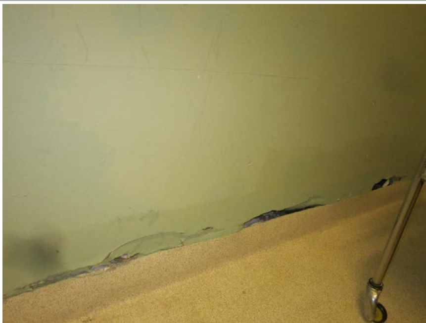
73. Vaskerom, slitte overflater og skader på vegg.
