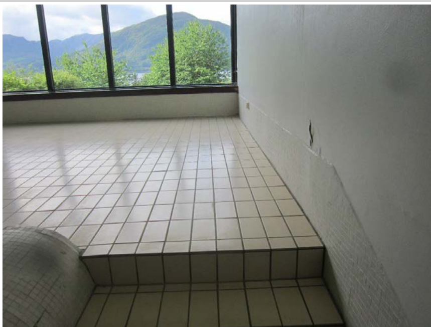
40. Svømmehall: Skade på veggflate.
