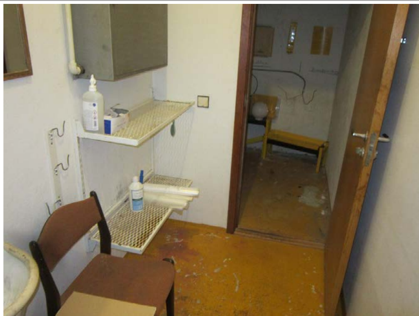
75. Batterirom, slitte overflater.
