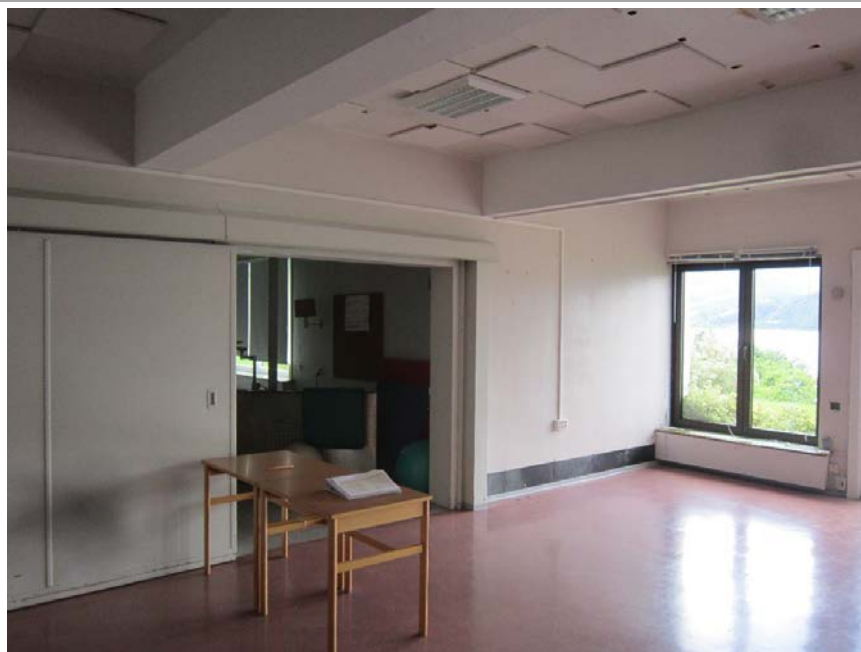
55. Korridor mellom kontor og svømmehall. Fuktskade ved vindu.
