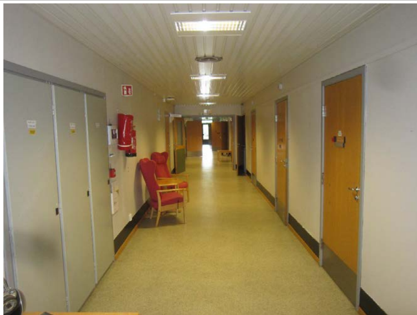
79. Korridor: Slitt gulvbelegg og overflater.
