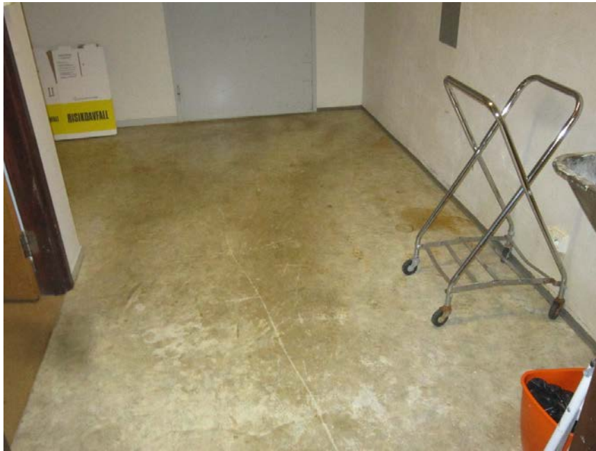
99. Korridor mot garderobe og vaktmesterfløy, nedslitt belegg
