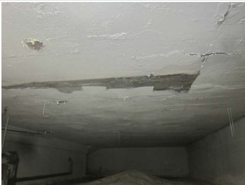
34. Over teknisk anlegg til svømmebasseng.
