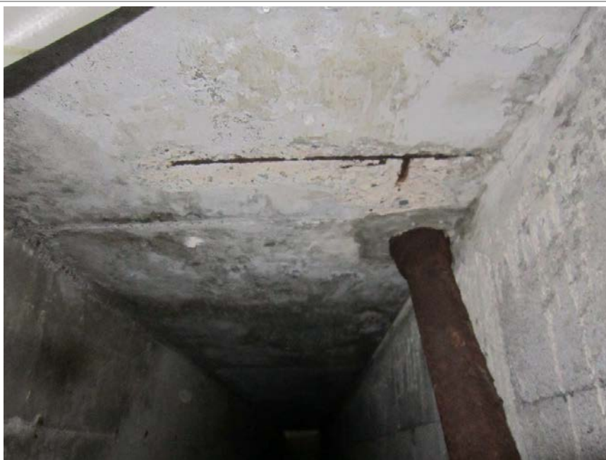
78. Under svømmebasseng. Rustsprengning fra armering.
