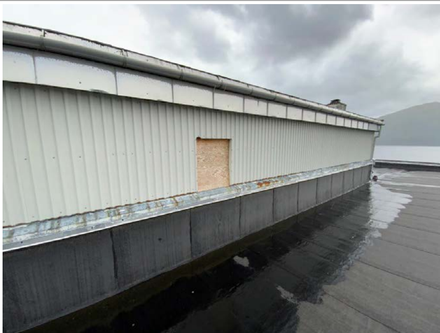
20. Avstenging av knust vindu etter innbrudd.
