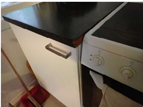
Mangler laminering på ende benekeplate mot komfyr
