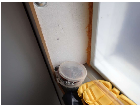
Isopor-kledning omramming rundt vindu soverom loft øst - enkelt glass - montert plastfolie på innsiden.
