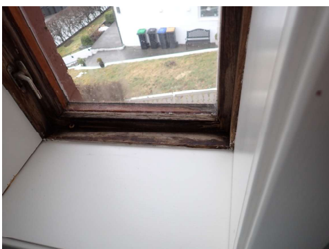
Vindu bad loft med fukt/råteskader
