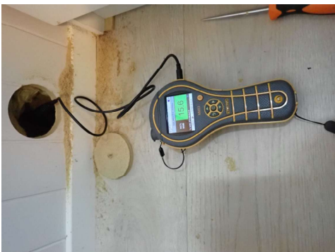
Målt 15,6 % i bunnsvill utforingsvegg mot mur
