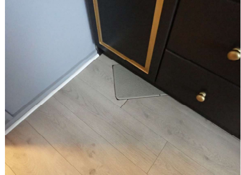
Ikke fjernet ubrennbar plate foran ildsted som er fjernet
