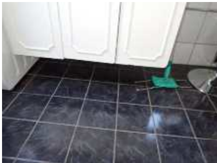
Fuktskader fronter innredning
