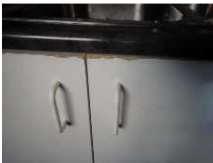
Småskade skapdører etter fukt
