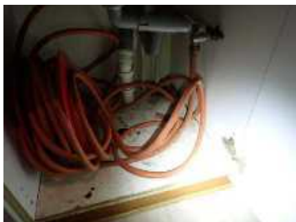
Skader i benkeskap - brannslange
