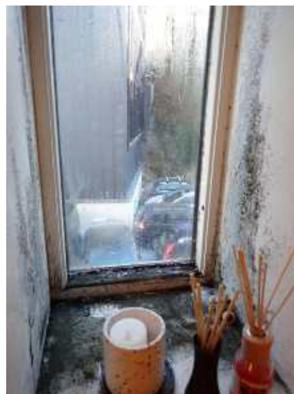
Mye soppevekst i vindusutforing
