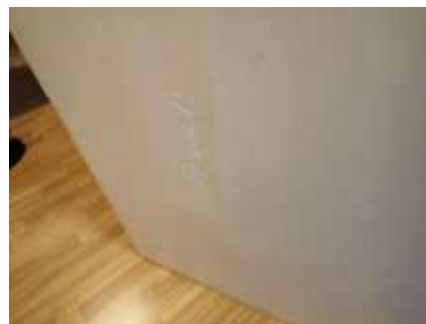
Skade i dørbblad ytterdør 3B er reparert
