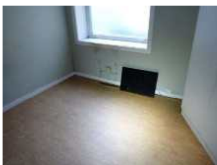
Svimerke i golv etter veggmontert panelovn
