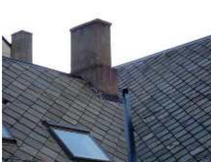
Slitt beslag overgang pipe/tak.
