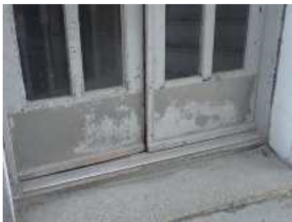
Hovedytterdør eldre dør med glassfelt - vedlikeholdsetterslep - luftlekkasje utetthet innadslående dør
