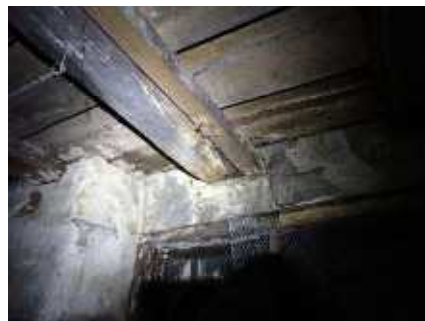
Mottskader/fuktskader og sannsynlige råteskader
