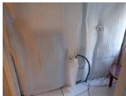
Bod 3B mot bad 3A - ikke kledning - isoporisolasjon i vegg ikke lovlig isolasjon - ikke brannskille mellom leiligheter
