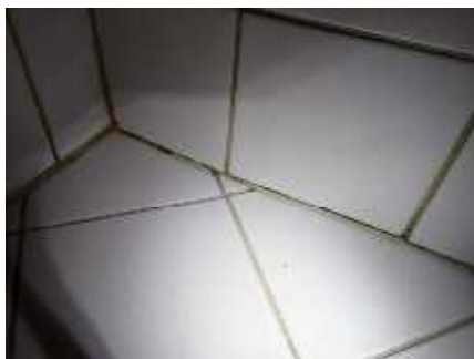
Sprekk i brede flisfuger
