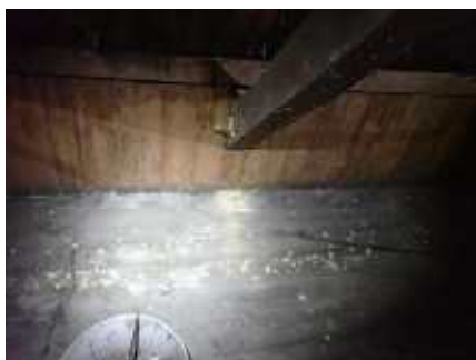
Mottmel på golv drysset fra takkonstruksjon
