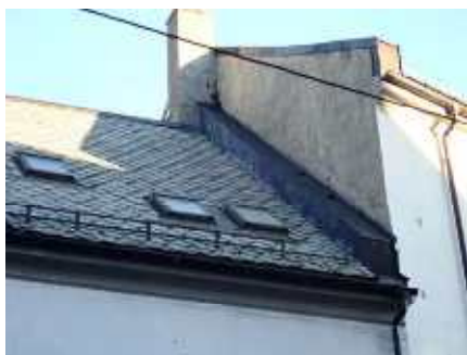
Rustskader beslag mot nabobygg sør.
