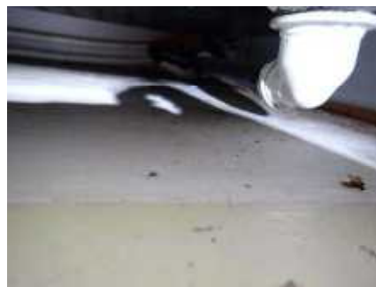
Avløp fra dusjkabinett i rør til avløp i vegg - ikke sluk i golv
