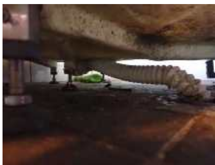
Sluk under dusjkabinett
