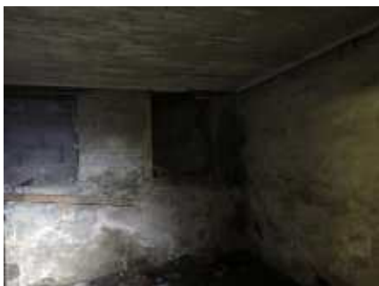
Trepanelt himling i del av kjeller i bakkant muggbelagt
