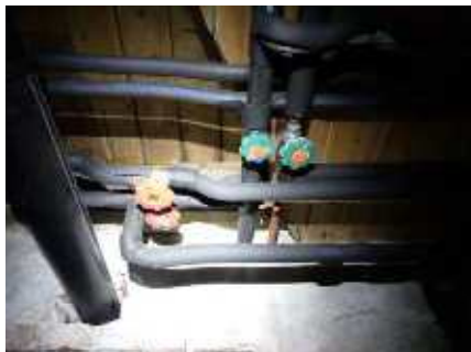
Isolerte kobberrør i kjeller Avløpsrør er både plast og støpejernrør
