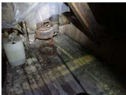
Plast opphengt for å samle vann etter lekkasje
