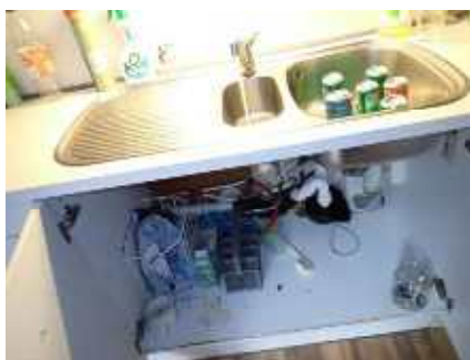
Skader etter fukt i skap
