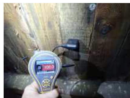
Målt 100 % fukt indikerer råteskade
