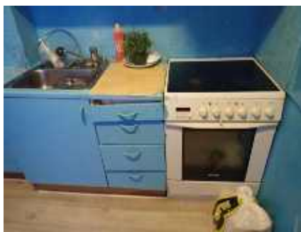
Innredning med skader
