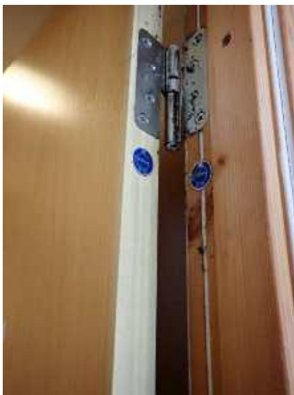
Entredør 2A er B-30 dør
