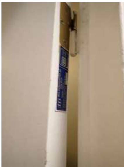
Entredør 3A er B-30 dør.
