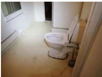
Fuktskjolder i belegg ved wc.
