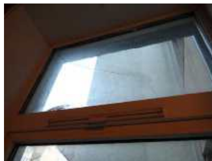
Sprekk i vindu bad 1B
