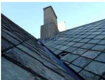
Mangler takstein ved gradrenne mot øst - bilde tatt gjennom takvindu leil 3B
