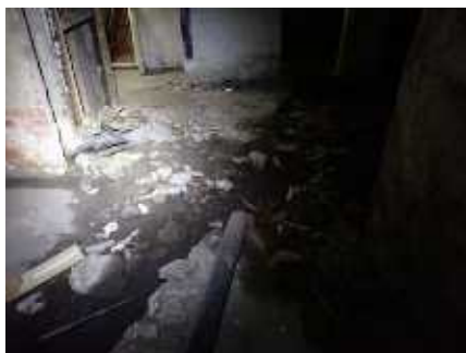
Opphugget golv - vått i kjeller
