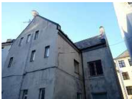
Sprekker i ubehandlet fasade mot bakgård
