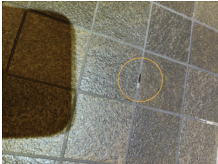
Eksempel riss flisfuge
