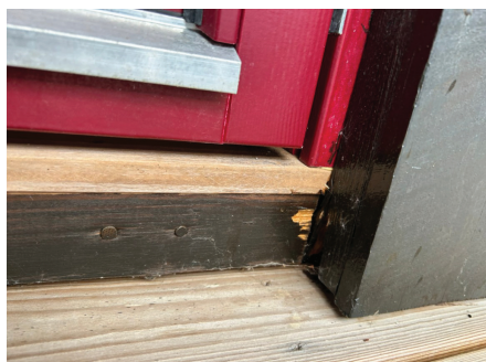
Altandør uten beslag under dør
