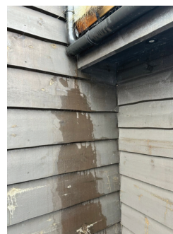
Vann lekker fra takrenne nedover vegg
