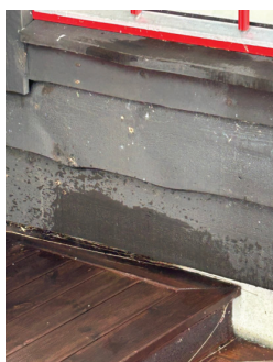
Vann lekker fra takrenne nedover vegg
