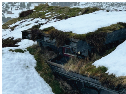
Torv/lyng legger seg i takrenne
