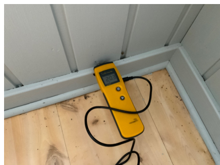
Høyt fuktnivå også registrert i panel i soverom
