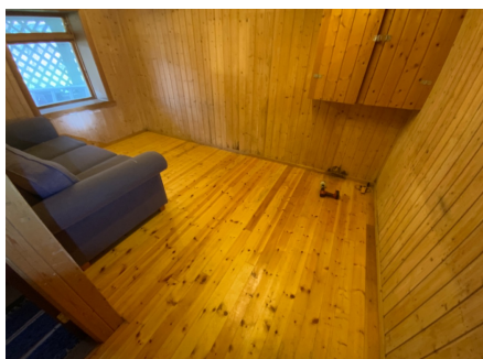
Synlige skader på gulv og vegg i kejjellerstue
