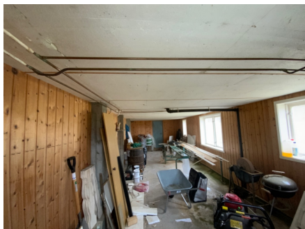
Dårlig isolerte vannrør
