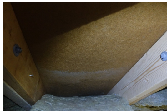
Bildet viser kondensering på undertak da ny isolasjon er lagt til undertak uten lufting.
