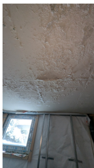
Himling på rom under vaskerom/bad i kjelleren.
