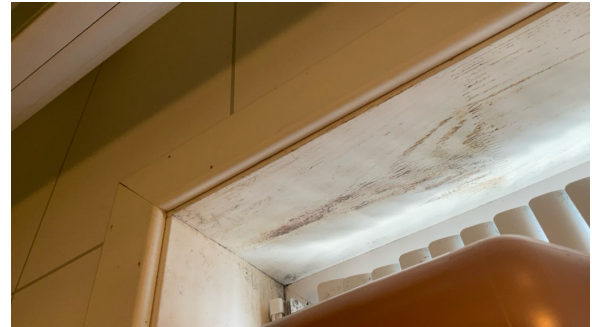
Fuktmerker i vindu
