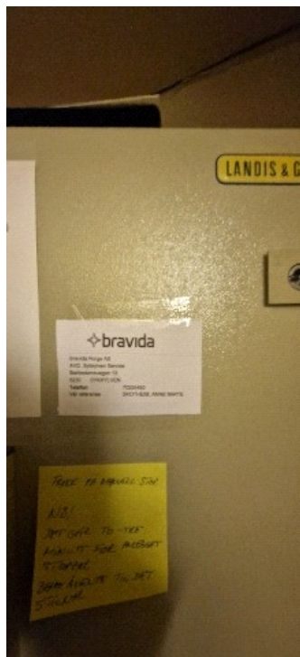
Teknisk styreskap ventilasjon
