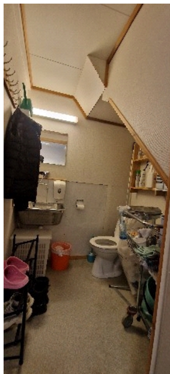
WC 1.etg. toalett og bøttekott
