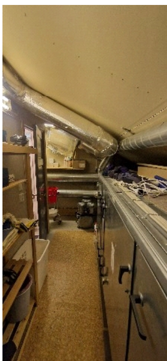
Teknisk rom 2.etg.
