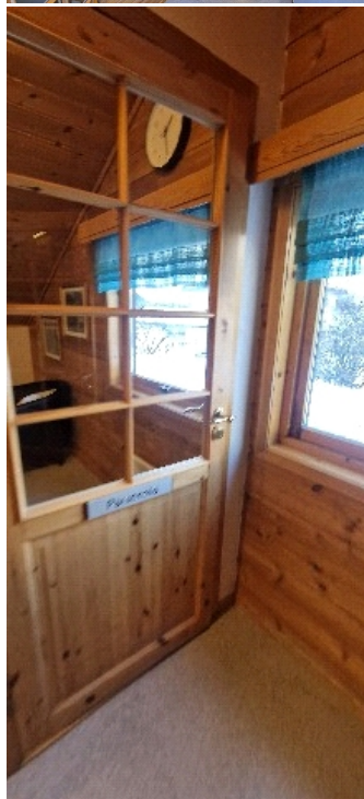
Typisk 2.etg. Noe fukt skjolder i vinduskarmer
