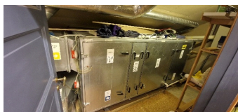
Aggregat i teknisk rom 2.etg.
