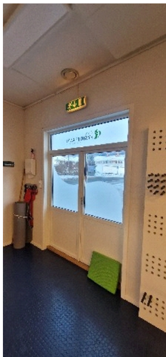
Treningshall 1.etg. Merket rømningsvei mot øst, markeringslys.
