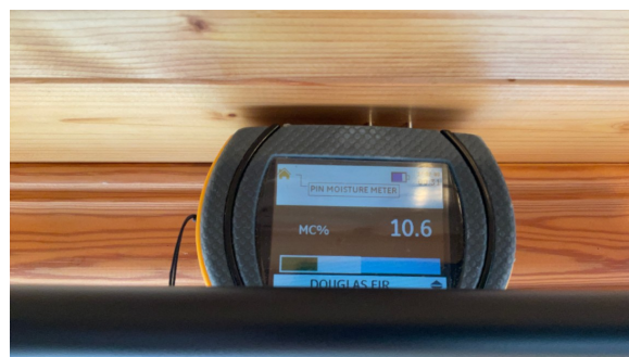
Det er målt < 14, ved drager i karnapp, det er tørt ved vår befaring.
