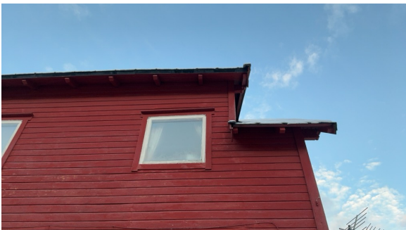
Manglende takrenne og nedløp på takopplettet, samt på et lite parti ved siden av takopplettet.
