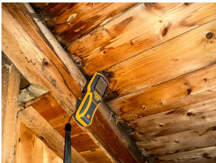
Fuktmåling viser en verdi på 21,5 %.
