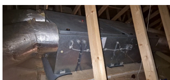
Ventilasjonsaggregat på kaldt loft.
