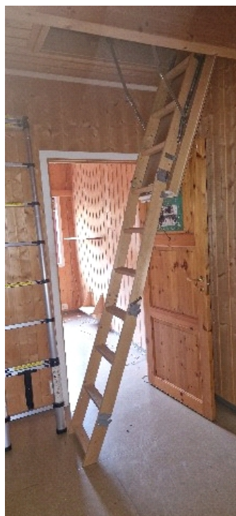
Adkomst med stigeluke til mørkeloft for tilsyn ventilasjonsaggregat.
