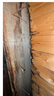
Bildet viser tydelige fuktskader og begynnende nedbrytning i treverk ved taktro/sperre. Misfargingen og mørke felter langs bordskjøter er typisk for langvarig fuktpåvirkning, ofte fra lekkasje eller kondens.
