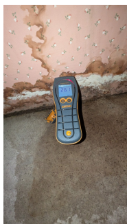
Fuktmåling på knevegg loft på innredet rom
