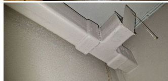
Kanaler av eternit. Sannsynlig asbestinnhold.
