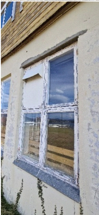
Eldre vinduer. Slitte utidsmessige vinduer, malingsslitasje på vinduer og mur.
