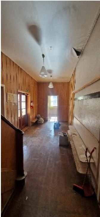
Gang 1.etg. Lekkasje i himling (ved pipe)
