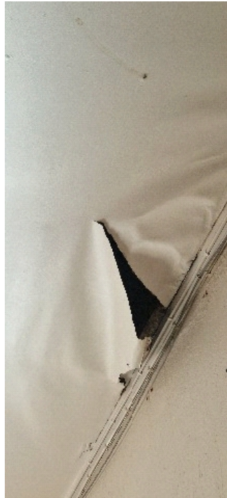
Lekkasje i himling (ved pipe)
