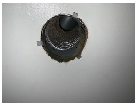
Mye støv i ventilasjonskanaler, som bør renses i hele huset.
