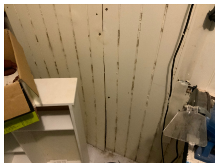
Sopp og fuktskadde plater på bakmur
