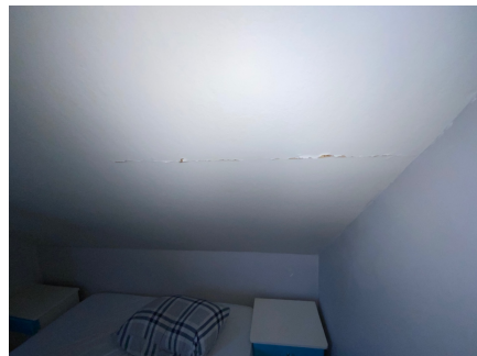
Sprekker på malerpapp på loft
