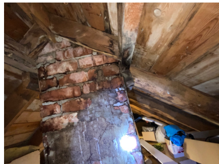
Skjolder rundt pipegjennomføring.
