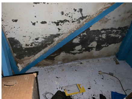
Fuktskader på grunnmur.
