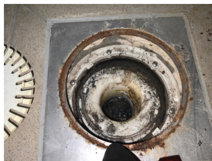
Synlig spor etter membran i sluk under klemring.
