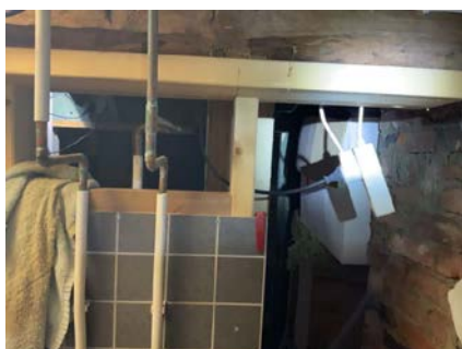
Mye skjøteledninger kjeller, forsynt fra anna skjøteledning
