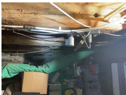
Mye skjøteledninger kjeller
