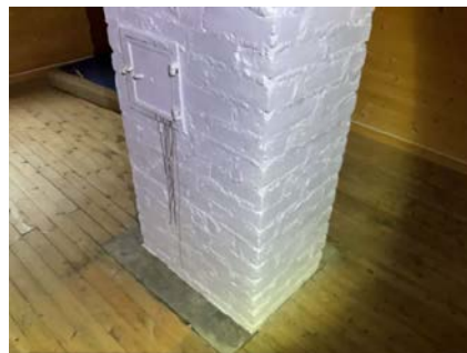
Ikke plate på gulv
