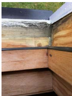
Loftsvindu gavnl nord, fukt/råte
