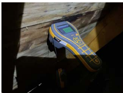
Fuktskjolde, normale fuktverdier
