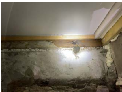
Kjellerdør sør trekker fukt
