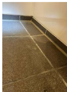
Høydeavvik og manglende fuge i hjørne og under bunnprofil(fuge utbedra av eier etter befaring)
