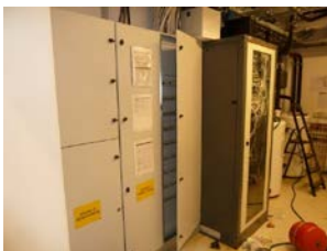
Tidsmessig og driftstilpasset elinstallasjon. 400 Volt.
