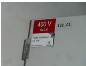
Tidsmessig og driftstilpasset elinstallasjon. 400 Volt.
