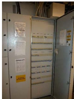
Tidsmessig og driftstilpasset elinstallasjon. 400 Volt.
