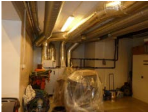
Industriareal ved verkstedhall. Ventilasjonsanlegg
