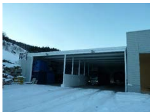
Mot øst åpninger for fremtidig port. Mot nord til Bygg A på stålførsterket opplegg.
