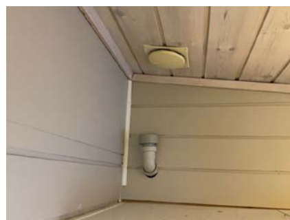
Naturlig avtrekk. Uheldig med kloakklufting inne på bad
