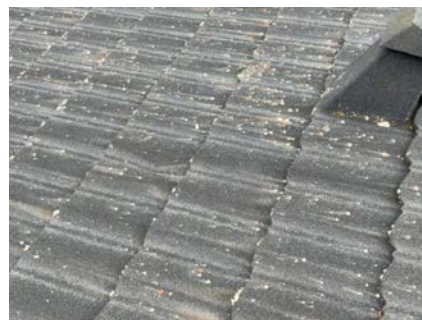
Det er en del bulker på takpanner.
