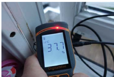
Viser fuktverdier/ råteskade.
