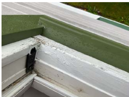
Fukt/råte i karm stuevindu
