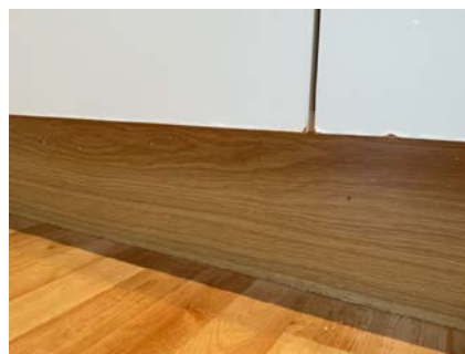
Sår og posning under benkeskap
