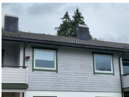
Værslitasje fasade sørøst
