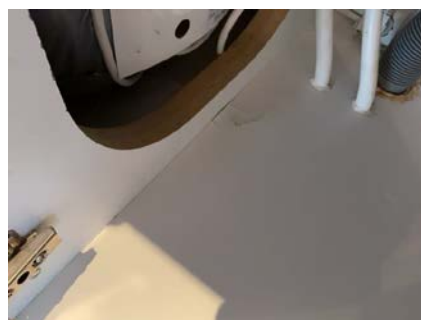
Skade ved varmtvannstank
