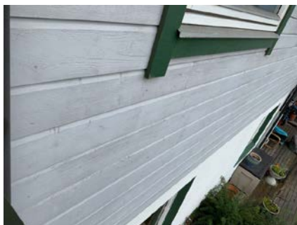
Værslitasje fasade sørøst
