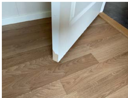
Avslitt kantlist soverom ved inngang
